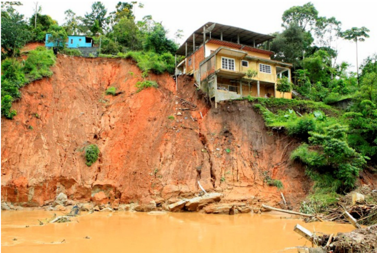
Figura 1. Efeito das chuvas (2011) sobre as moradias numa zona de risco na cidade de Nova Friburgo, Rio de Janeiro, Brasil
